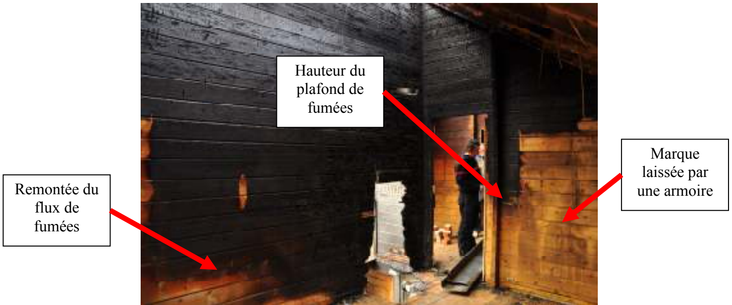
Plafond de fumées dans la pièce de droite
