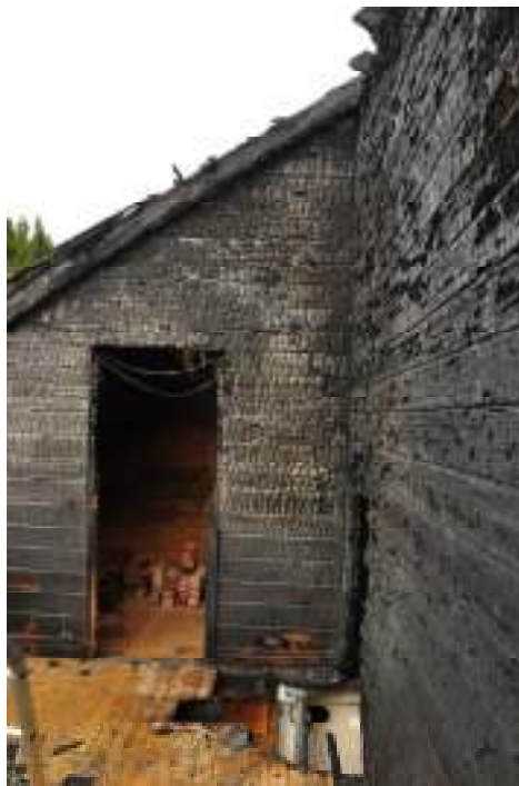
Plafond de fumée dans la pièce de gauche. Le toit a été enlevé après le sinistre.
